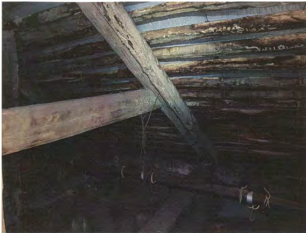
Фото 9. Протяженная продольная трещина в стропильной ноге.
