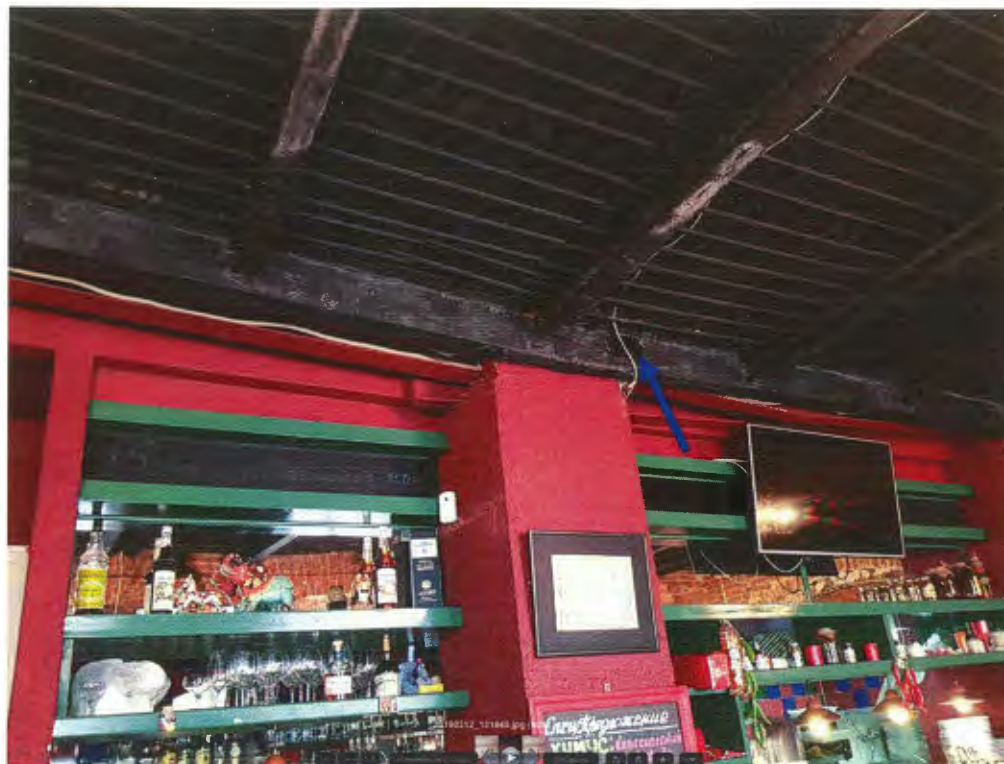
Фото 9. Общий вид перекрытия над 1 этажом в осях «2-3/В-Д». Стрелкой отмечена сквозная дырка в главной стальной балке перекрытия. Также можно отметить видимый прогиб балки.
