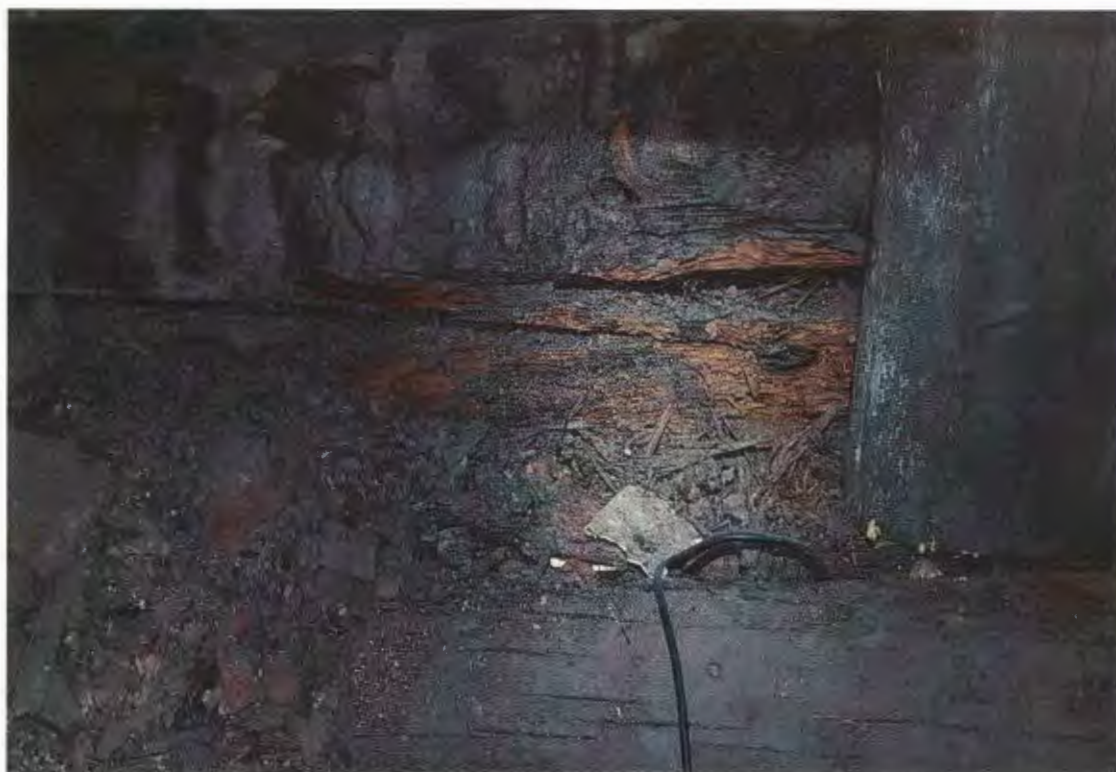
Фото 16. Гниль деревянной балки перекрытия на глубину до 50 мм.
