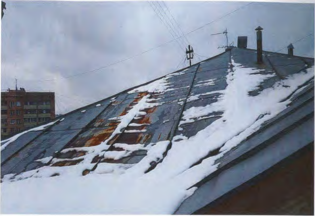
Фото 17. Коррозия стальных листов кровли.
