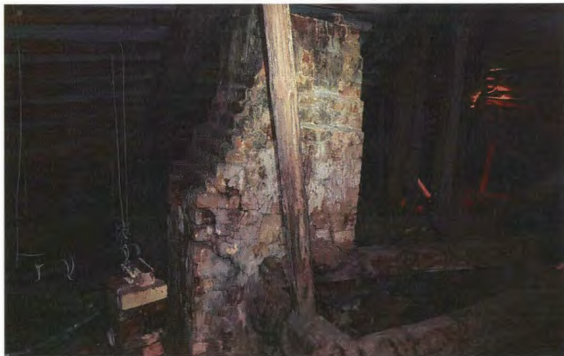
Фото 12. Крен кирпичного дымохода и частичное его разрушение.
