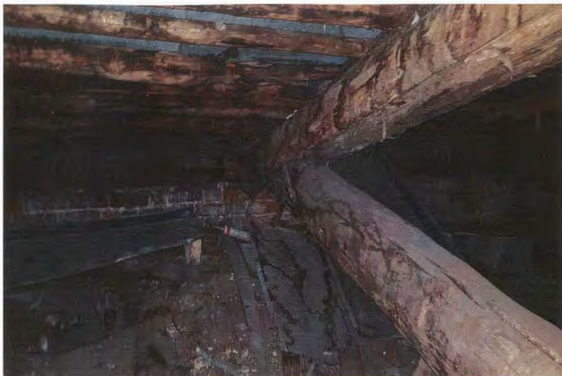
Фото 13. Гниль стропильной ноги (в нижней части), мауэрлата, обрешетки.
