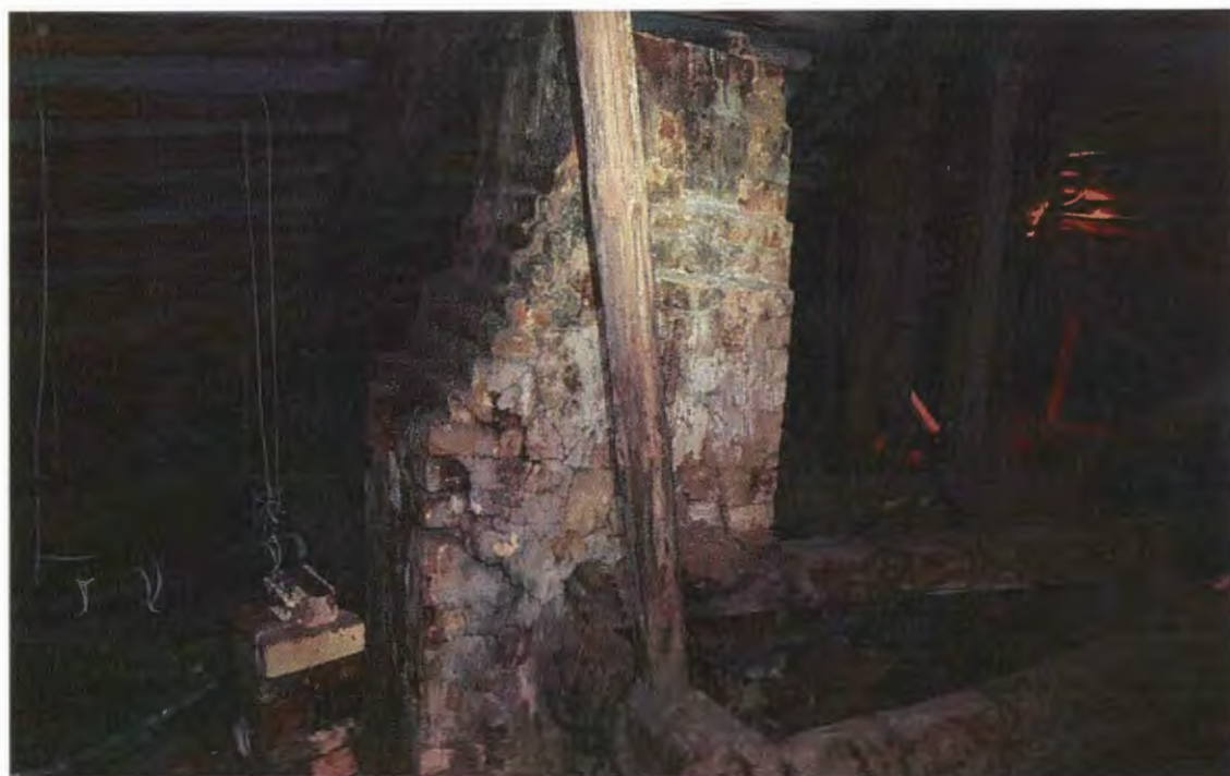
Фото 12. Крен кирпичного дымохода и частичное его разрушение.
