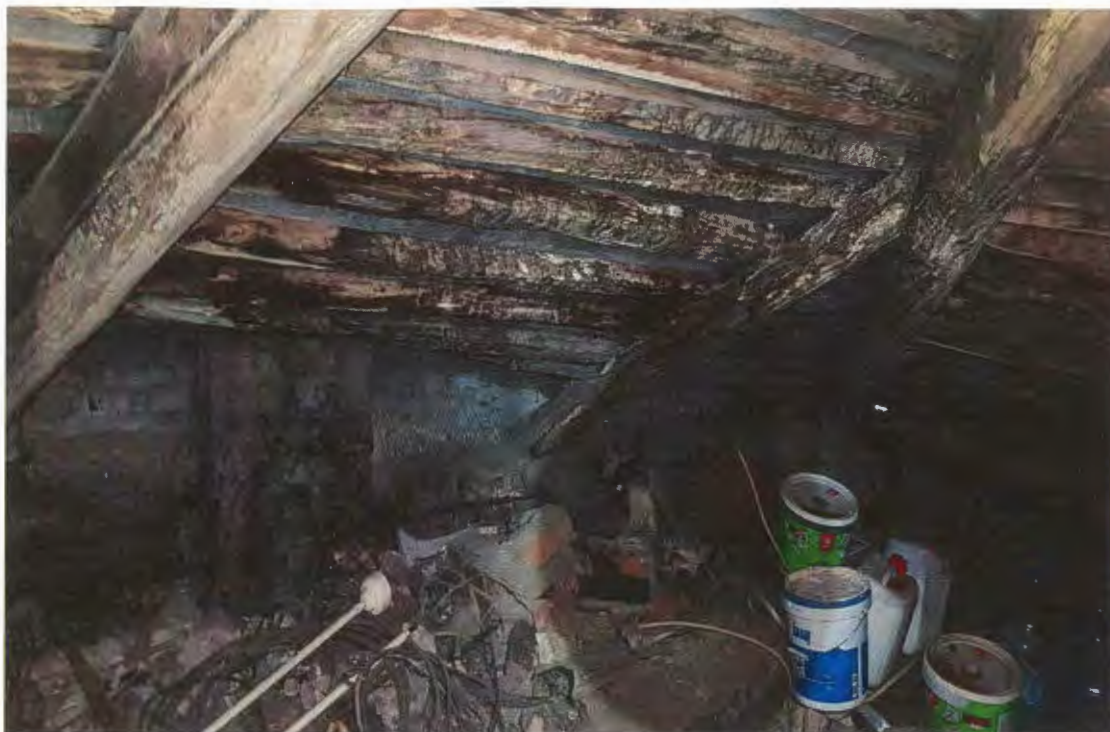
Фото 15. Чердак захламлен остатками строительных материалов, бытовым мусором.
