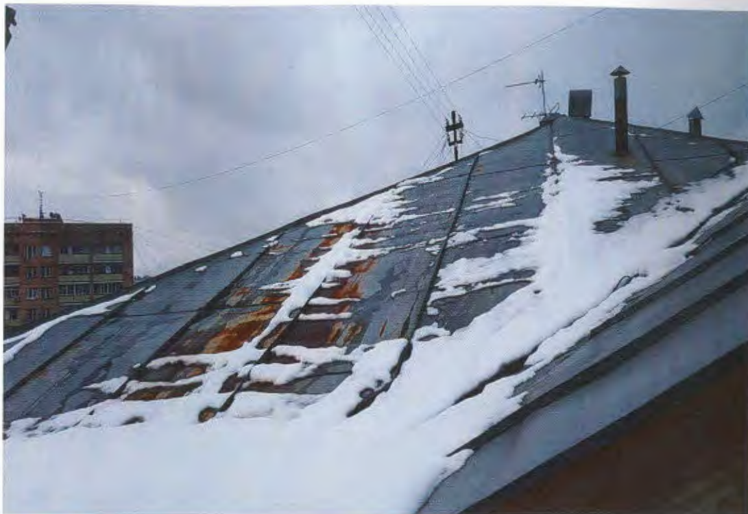
Фото 17. Коррозия стальных листов кровли.
