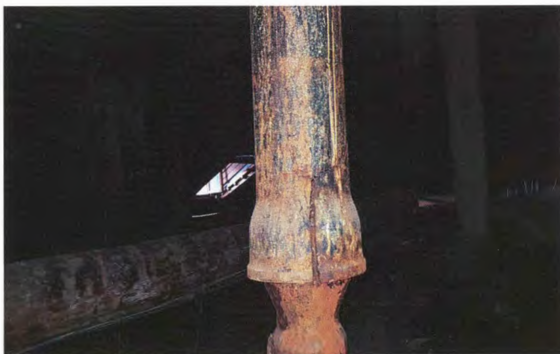
Фото 14. Трещина в чугунной трубе канализационного стояка, стояк не утеплен.
